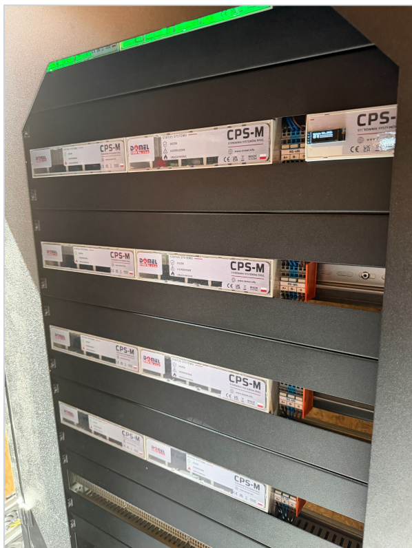
Moduły CPS-M w rozdzielnicy - lokalne wejścia, wyjścia i magistrala systemowa.
